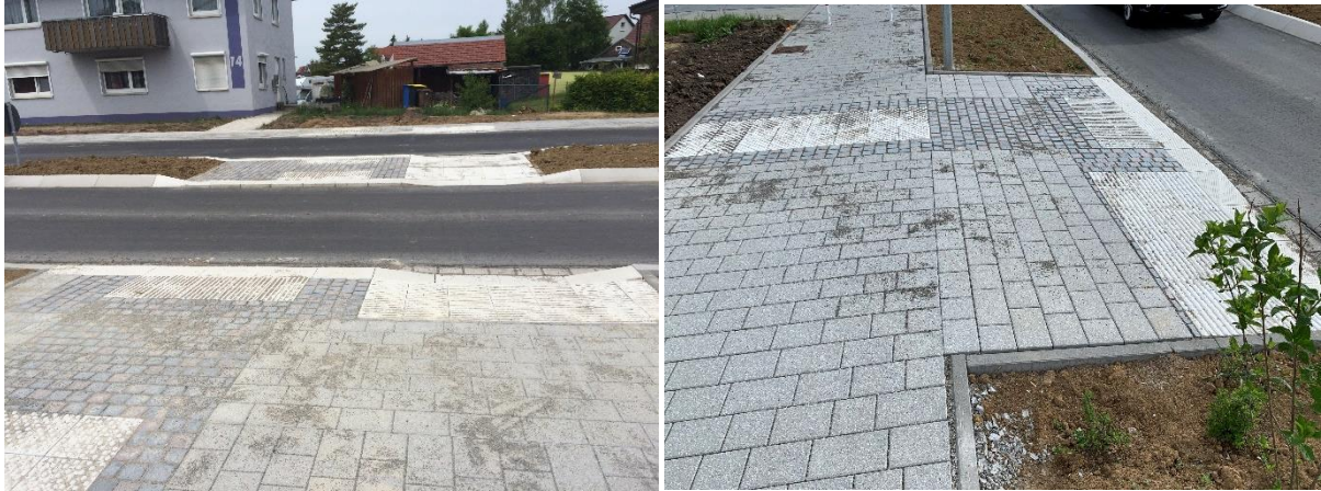
Fotos: Beispiel-Darstellung der DIN-gerechten taktilen Borde und Pflastersysteme
